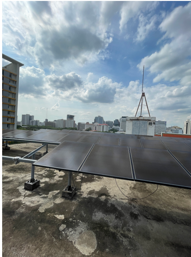
(a) แผงโซลาร์ชนิด Frontier (8 kW)
